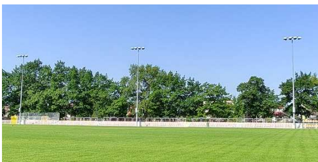
Zdjęcia – maszty oświetleniowe boiska – oprawy przeznaczone do wymiany na ledowe.
